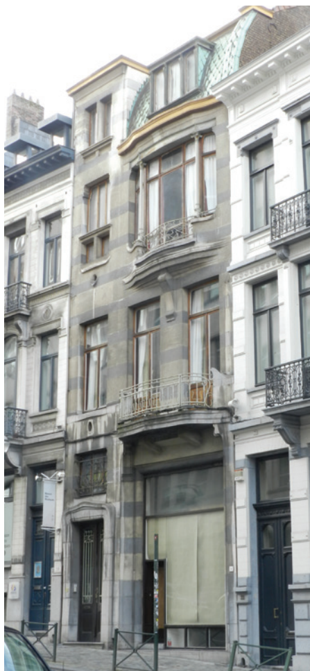
▲ Façade principale actuelle, 2020 (photo Guy Paulus). La façade fut fortement endommagée par des transformations scandaleuses au niveau du rez-de-chaussée, laissant un trou béant qui fera l'objet d'une restauration à venir.
